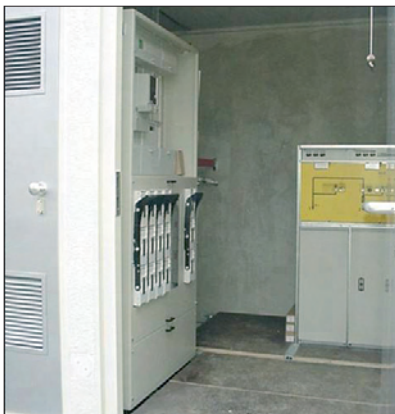
Bild 5: Integration einer NS-Verteilung in einer Betonfertigstation
